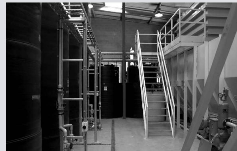
Photo d'ensemble des cuves tampons, du réacteur et du décanteur chez Silac (France).
