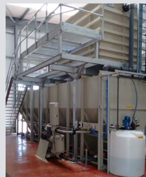
Le décanteur et le réacteur chez Smart Systems au Royaume-Uni. Cette installation assure un débit de 4 m 3 /h.
