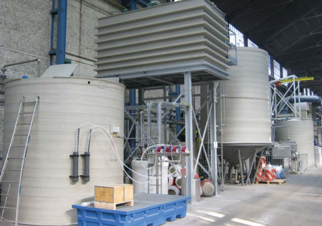
La cuve tampon, le réacteur et le décanteur vertical chez AGC.
